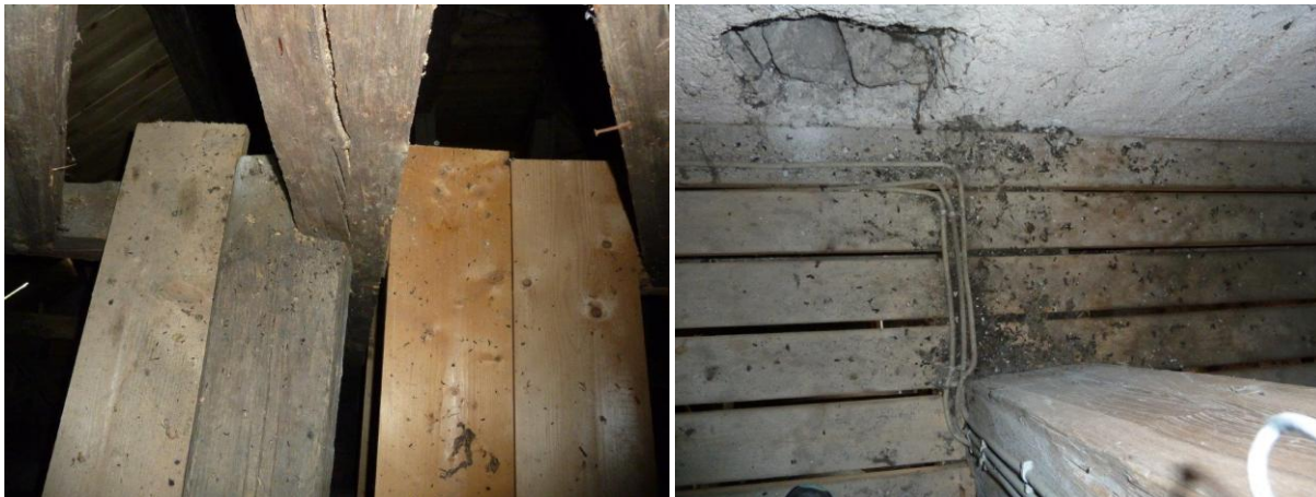
Abb. 2: Kot im Dachboden (linkes Bild) und im Turm (rechtes Bild)
